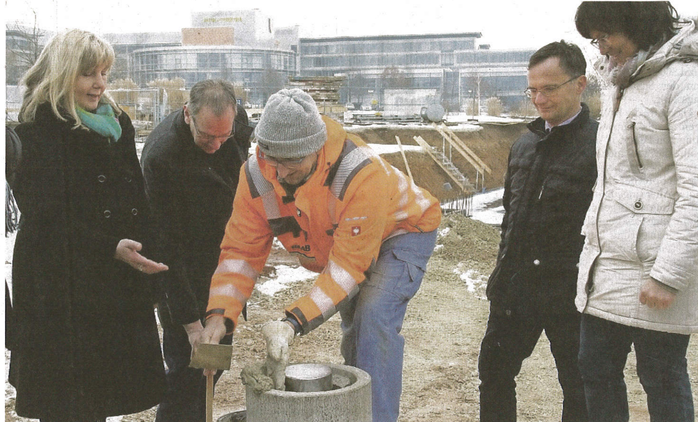
Symbolische Grundsteinsetzung: Polier Friedrich Schratz (Mitte) bereitet den Behälter für die Zeitkapsel vor, unterstützt von Zweiter Bürgermeisterin Birgit Weber, Drittem Bürgermeister Thomas Nowak, Heiko Krämer (LGA) und Bauherrin Gisela Raab.
